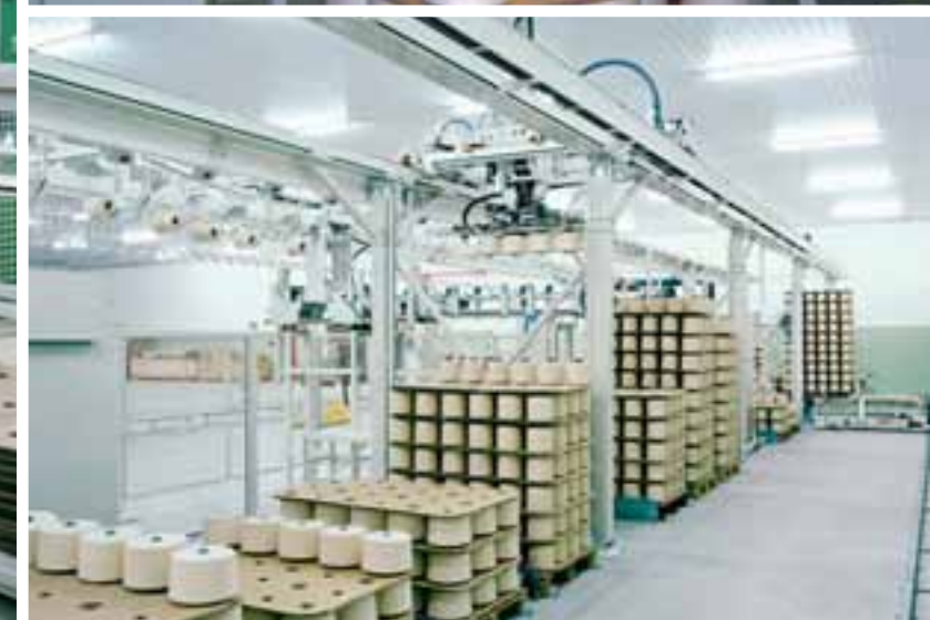
► INSTALACIONES DE PALETIZACIÓN DE CONOS A LA SALIDA DE LAS BOBINADORAS ► PALLETIZING INSTALLATIONS AT THE EXIT OF THE WINDERS
